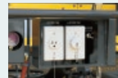
コンセント部
